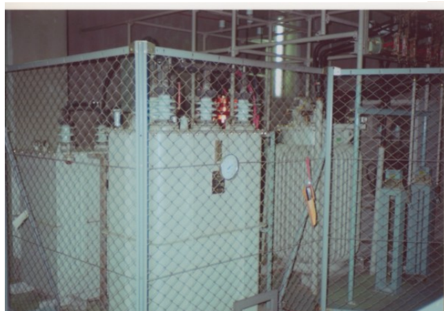
送信機の変調トランス(手前)と電源トランス(奥)
